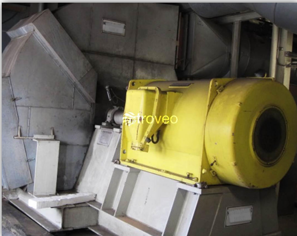
air inlet fan
